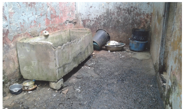
Bac à eau cassé
